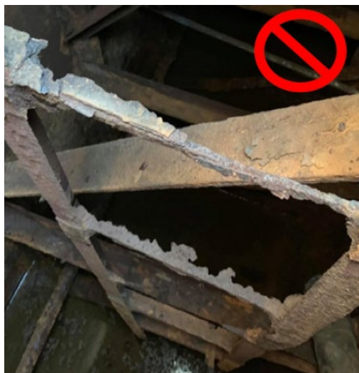
Ejemplo de escalera de acceso dañada.
